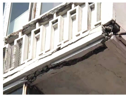
▼ 修整前的阳台
